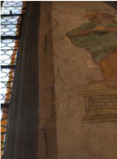
Ein Riss geht durch die Kirche
